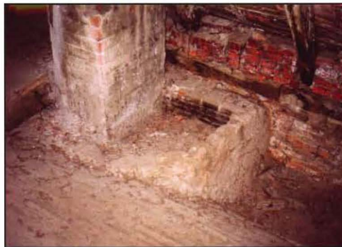
Fig. 9. Rest al coșului vetrei libere.
